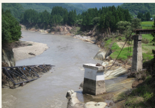
(1) 橋脚が流失した第7只見川橋りょう
